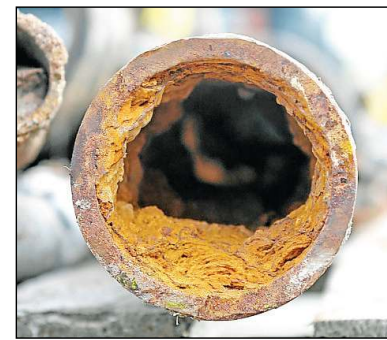
Marode: So sollten die Abwasserrohre nicht aussehen.
