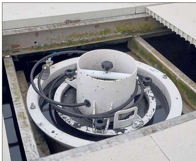
Hinter dem Belebungsbecken ist der neue Aktivkohlefilter geschaltet. Mehrere dieser Pumpen sind regulär mit Platten abgedeckt, um Einträge von außen zu verhindern.
