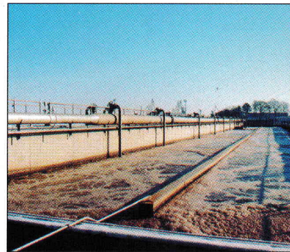
Die weitergehende Abwasserreinigung wird oft im Belebungsbecken durchgeführt.
