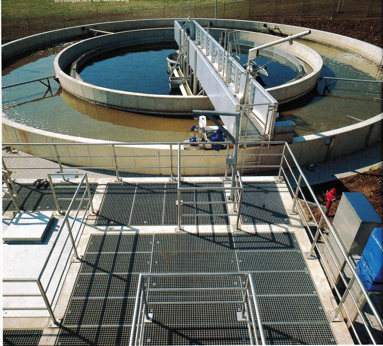
Belebungsbecken mit Nachklärung
